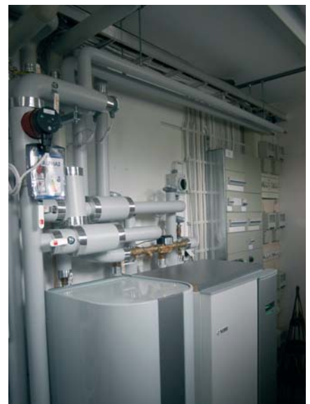
NIBE F1145-maalämpöpumppu talon teknisessä tilassa.
