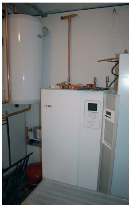
NIBE F1145 maalämpöpumppu talon teknisessä tilassa.
